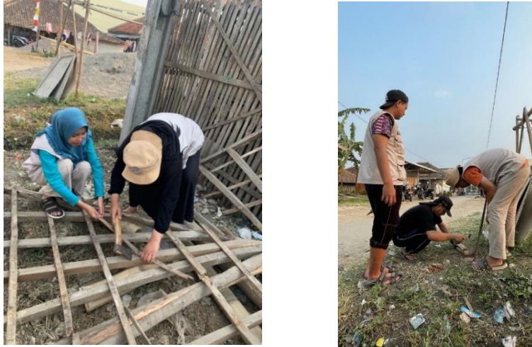
Gambar 7 dan 8. Kegiatan pemanfaatan kembali kayu-kayu bekas atap yang masih layak pakai dan proses pencabutan paku-paku yang masih tertancap pada kayu-kayu bekas atap
