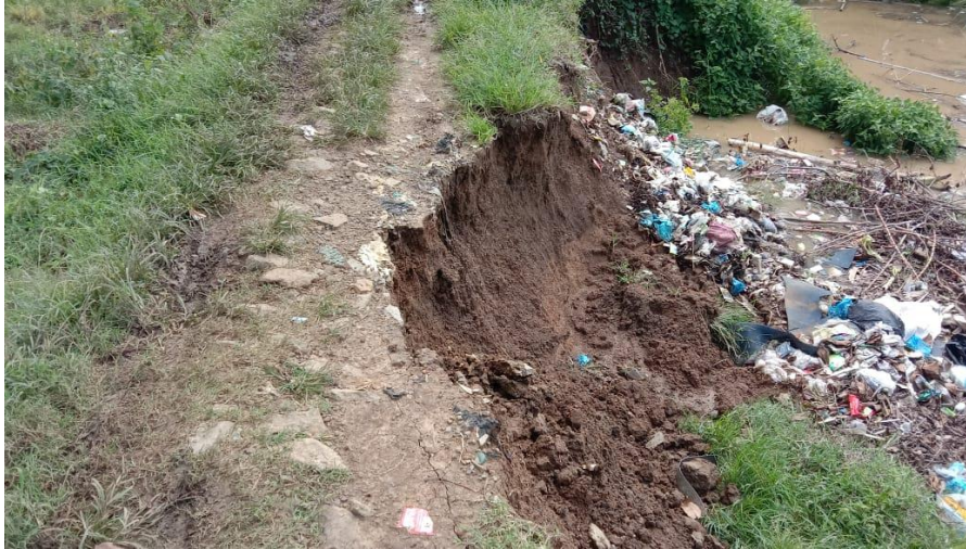
Gambar 1. Erosi tanah disekitar area bantaran tanggul sungai
