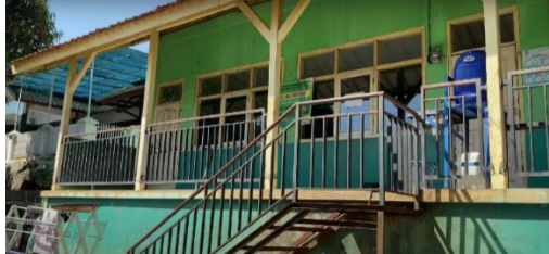
Gambar 4. Kondisi Gedung Belajar MDT Al-Fathu
