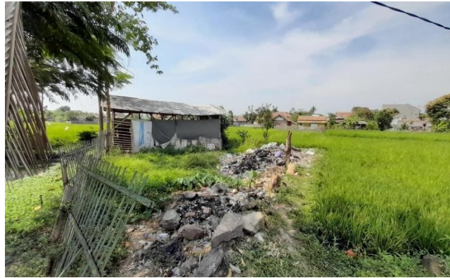
Gambar 1. Kondisi TPS Dusun 1 Desa Panyadap Sebelum di Perbaiki
